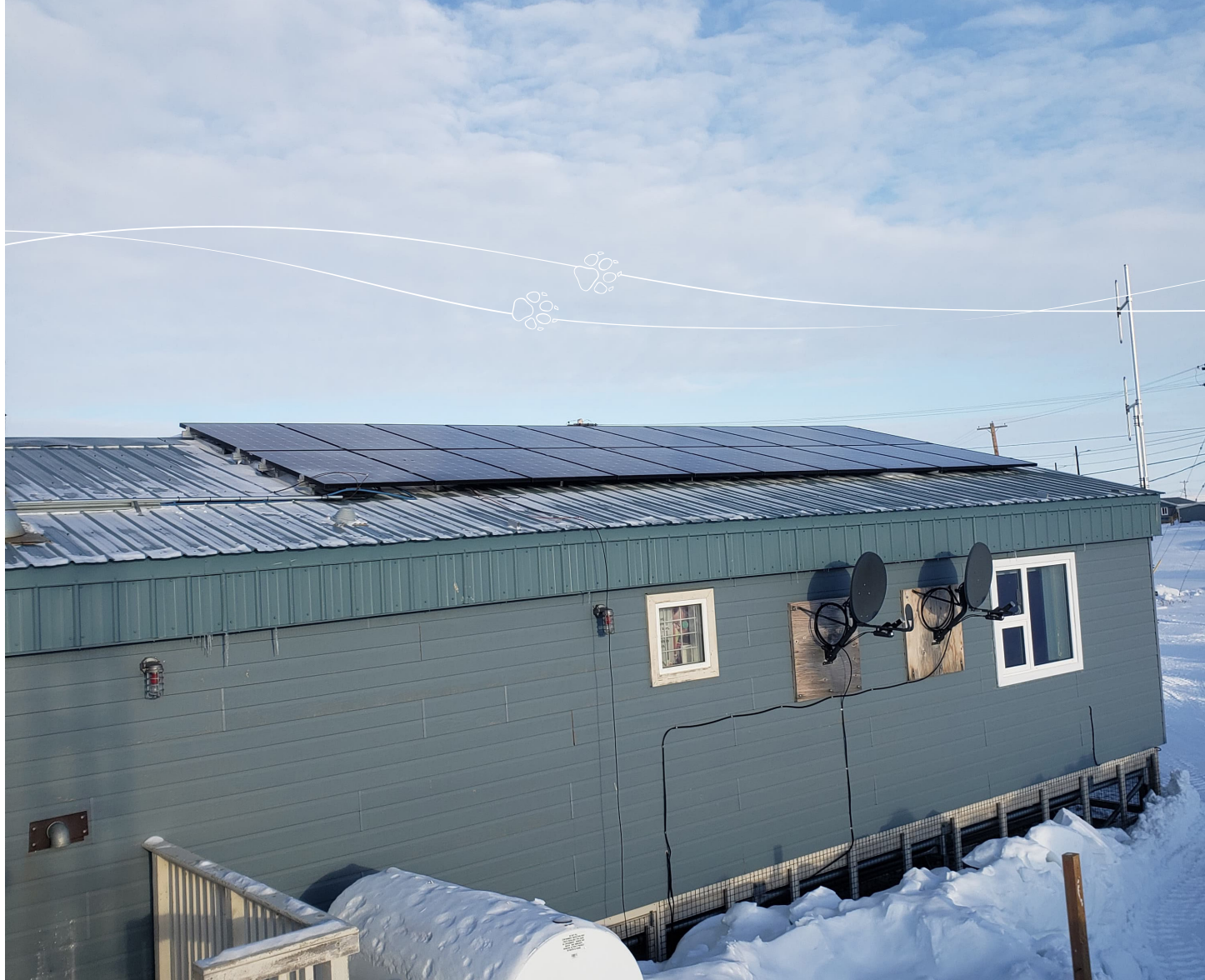
Panneaux solaires sur un immeuble à Paulatuk
