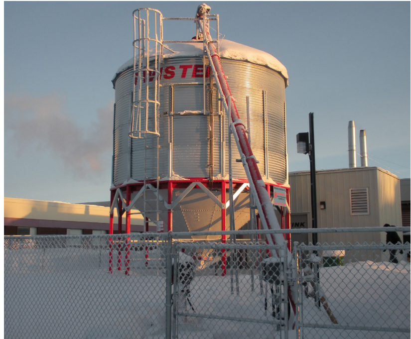
Chaudière à granulés de bois à l'école Chief Jimmy Bruneau, Behchokò TNO
